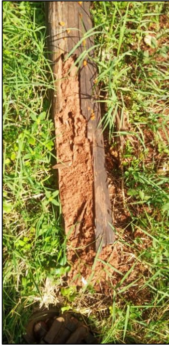
Door termieten aangevreten paaltjes
